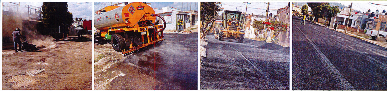
2. Calle San Cornelio entre las calles San Antonio y San Andrés col. La Providencia
